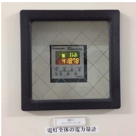
図 18 分電盤の電力量計
