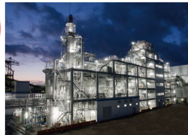
▲当社の下水汚泥処理設備です。
